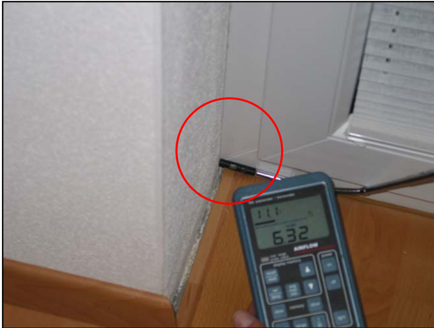
Abbildung 6 : Untere Ecke einer Fenstertür, Strömungsgeschwindigkeit v = 6,32 \text{ ms}^{-1} .
