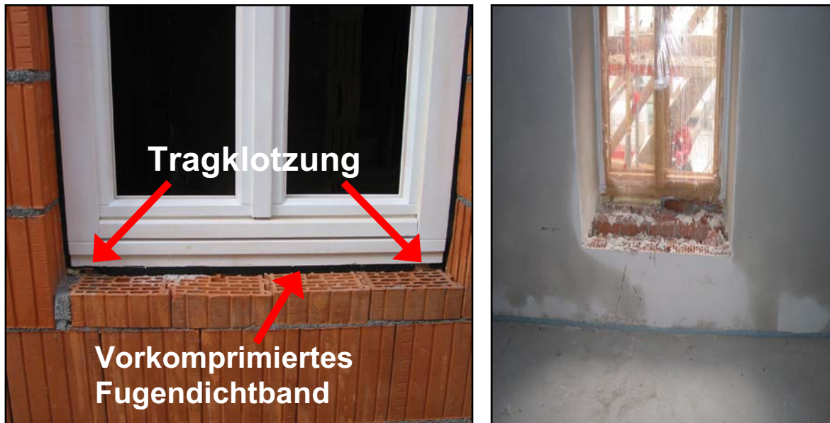
Abbildung 12: Mangelhaft vorbereitete Brüstungsflächen.
