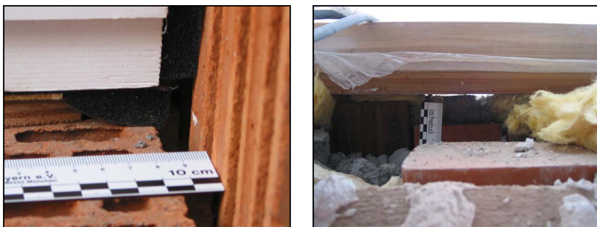
Abbildung 13: Mangelhaft vorbereitete Brüstungsflächen.
