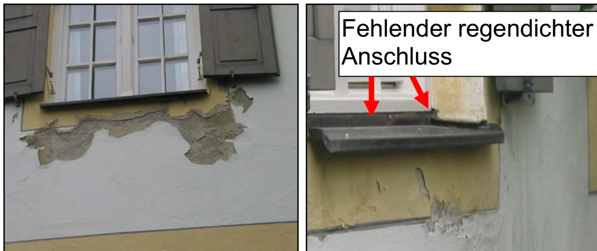
Abbildung 8: Ansicht Fassade mit erheblichen Feuchteschäden unterhalb der Fensterbank aufgrund der Hinterläufigkeit des Fensterbleches.
