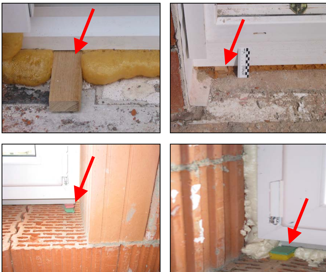
Abbildung 2: In der Praxis häufig vorzufindende mangelhafte Tragklotzungen.
