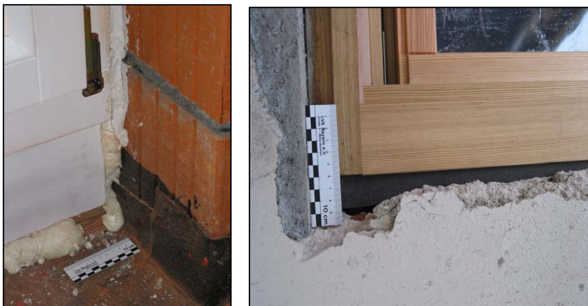
Abbildung 5 : Mangelhafter Einsatz von Montageschaum, Unterlagsplättchen und Dichtband.
